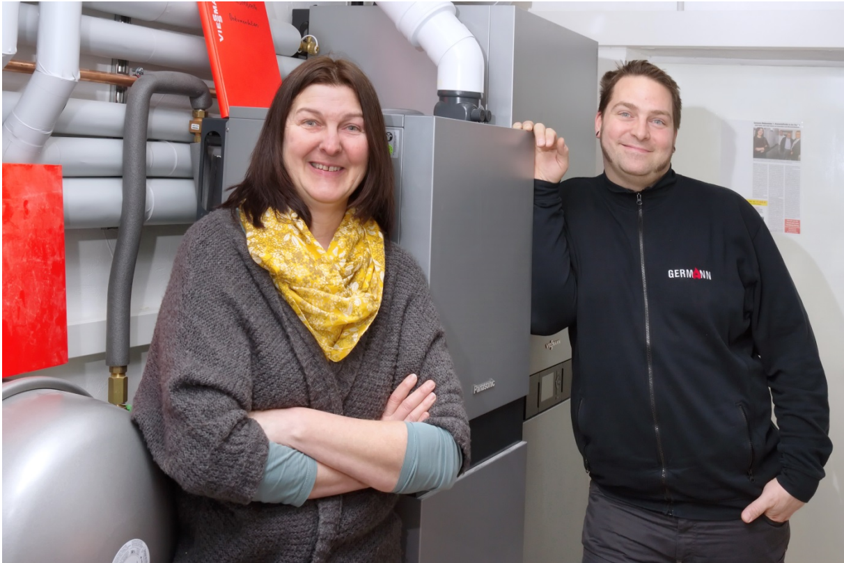
Heidi Nelius zusammen mit Germann Projektleiter Nils Müller vor dem Brennstoffzellen-Heizgerät Vitocalor 300P
